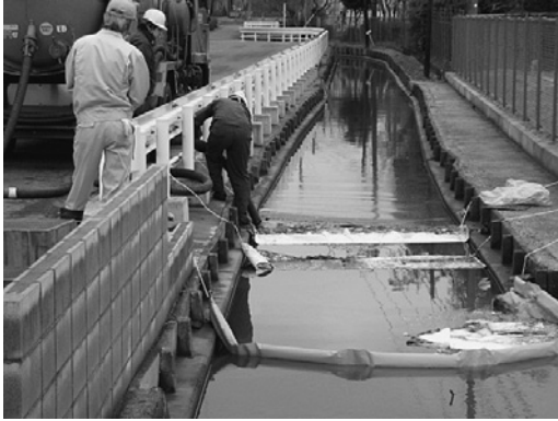
▲油類流出事故処理のため、オイルマットを設置後、バキューム車による油類回収作業実施
