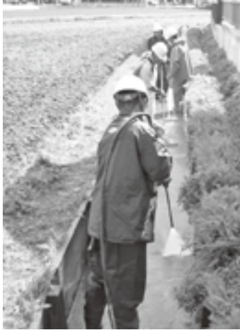
▲油が流出した水路の洗浄作業
