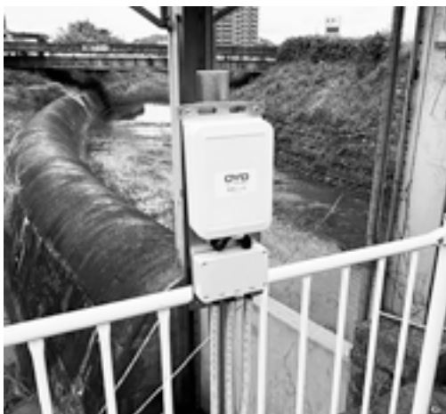
▲増水検知センサーを2か所に設置。複数深度でのセンサーの接続により、水位の変動を段階的に検知し、メールが配信される仕組み
