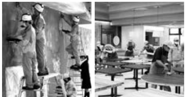
▲食堂で土壁塗りに挑戦する社員（写真左） テーブルの脚は以前の食堂で使用していた脚を再利用（写真右）
