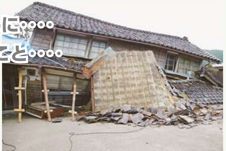
「新潟県中越沖地震(2007年)での住宅被害」 写真提供: 首都大学東京 土質工学研究室
