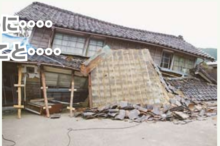
「新潟県中越沖地震(2007年)での住宅被害」 写真提供: 首都大学東京 土質工学研究室
