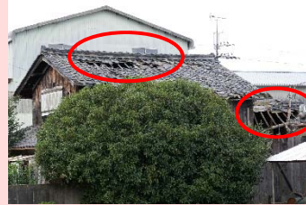
外観目視で屋根の崩落を確認 (柱や梁についても、著しい腐朽、破損が想定される)
