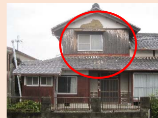
↑外壁仕上げ材の剥落
