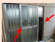
↑ガラス割れ、不施錠
