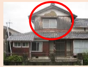
↑外壁仕上材の剥落
