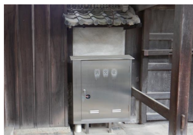
〔写真 6-2〕 消火栓（正門横）
