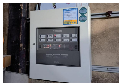
〔写真 6-3〕 自動火災報知機（主屋）
