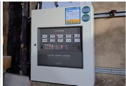
[写真 6-3] 自動火災報知機 (主屋)
