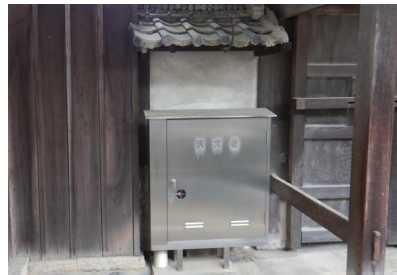
[写真 6-2] 消火栓 (正門横)
