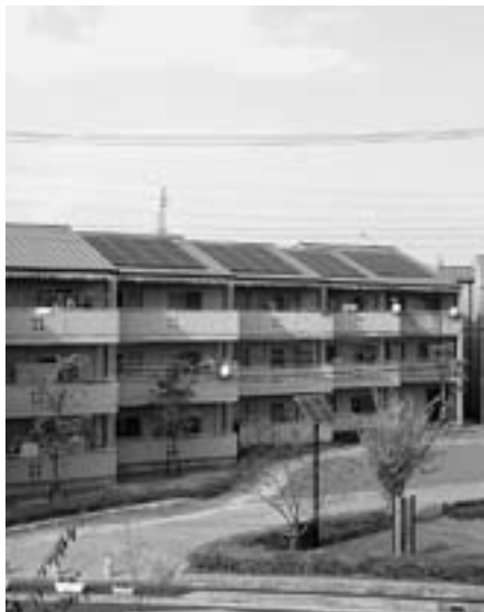
市営住宅に設置された太陽光発電設備
