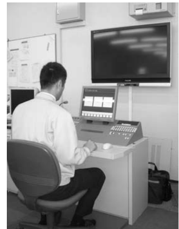
同報系防災行政無線親局設備…操作卓
