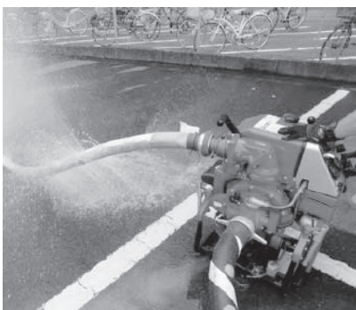
▲ホースの経年劣化による漏水の様子 (草津市内自治会)
