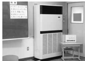
エアコンが設置された葉山通級指導教室
