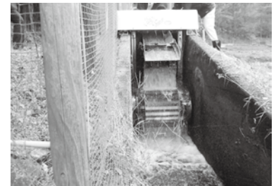
▲水力発電 米子水車(長野県須坂市)
