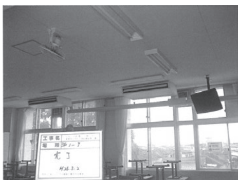
▲中学校の空調設備
