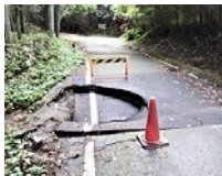
▲道々林道陥没写真
